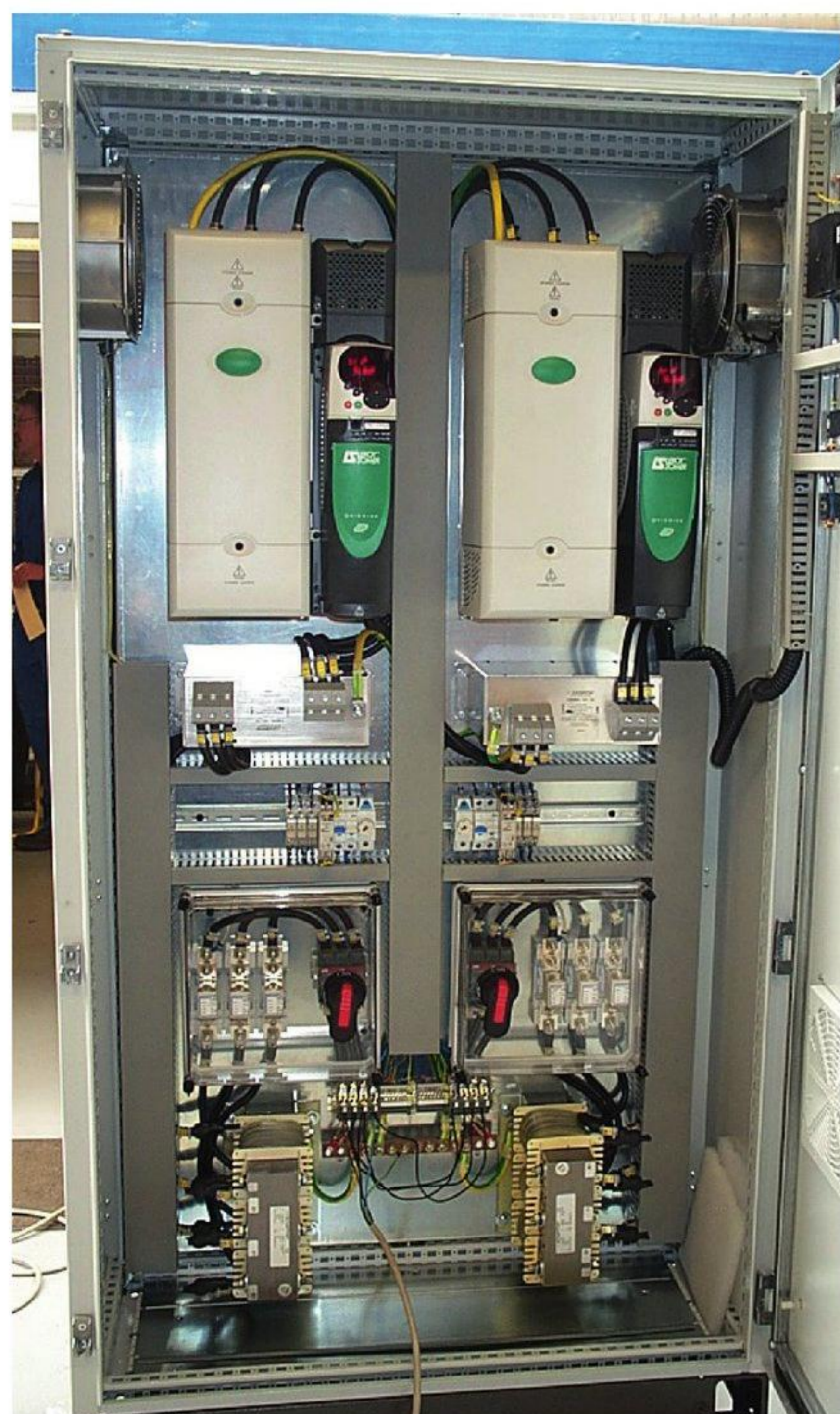
Ølgod Elektro A/S er specialiseret i at levere samlede løsninger, der omfatter motorer, drives og styringsenheder som denne styretavle med frekvensregulering.
